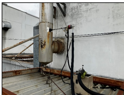
Factory 7 : ปล่อง Boiler No.1
